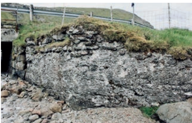
Betongið er sera illa farið.
