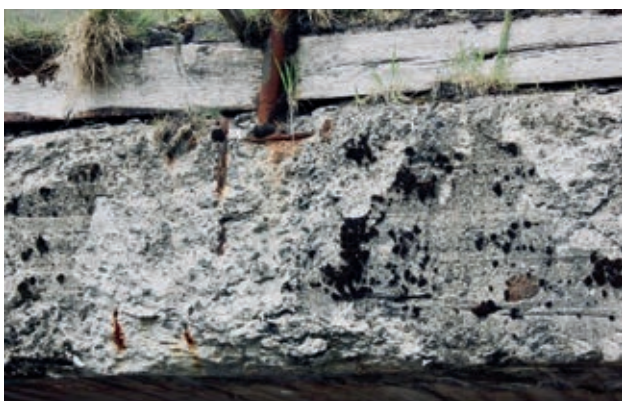
Betong flusnað av armeringini.
