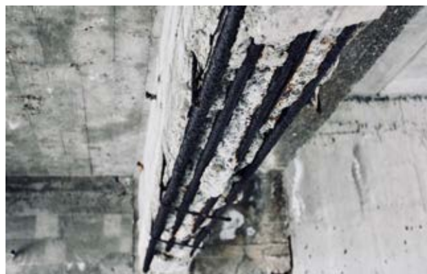
Sjónlig armering og illa farið betong
