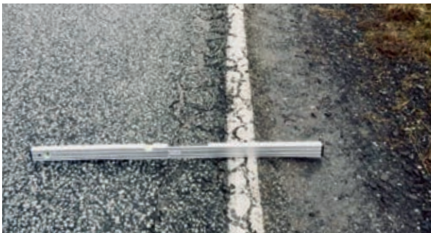
Mynd 5: Dæmi um avleiðingar, tá viðlíkahaldið fram við vegnum ikki er á einum næktandi stöði. Ein vátur vegabygnaður tolir ikki tunga ferðslu.
